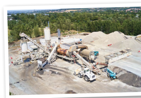
← Centrale d'enrobé de Bruquières
